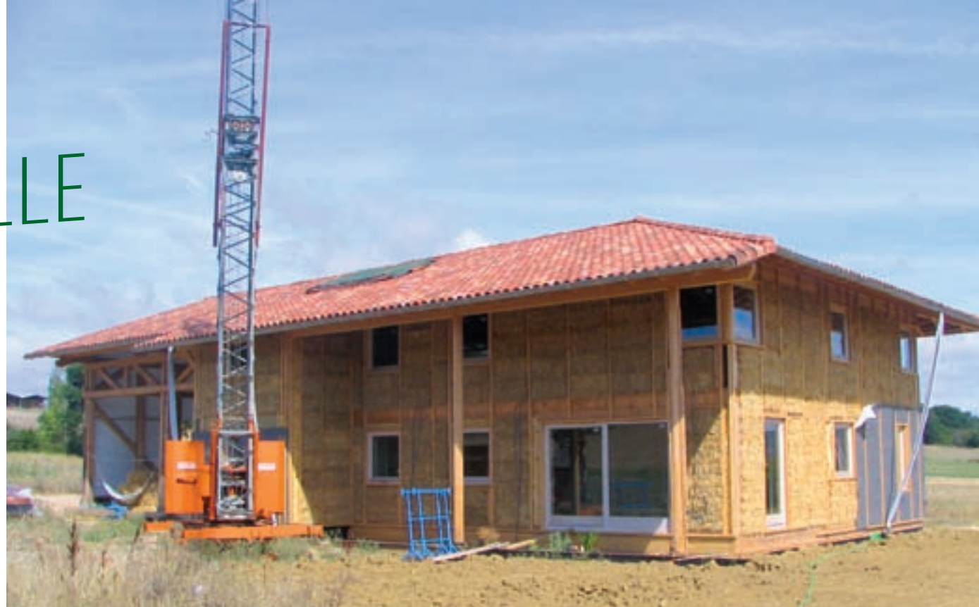
VUE DE LA FAÇADE SUD-EST. LES BOTTES DE PAILLE ENCORE APPARENTES VONT ÊTRE RECOUVERTES D'UN FILM PARE-PLUIE (VISIBLE SUR LE COIN DE LA MAISON) ET D'UN BARDAGE DE BOIS.
